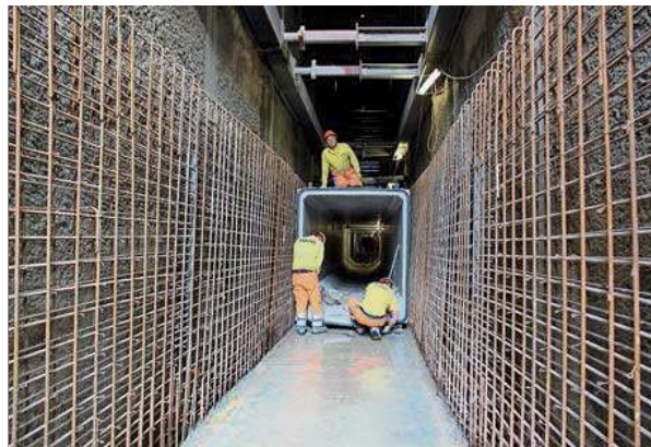
Die Armierungseisen stehen bereits. Wenn die Elemente fertig verankert sind, werden sie mit Flüssigbeton stabilisiert. Foto: kst.
